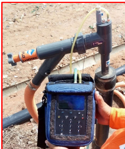
Figura 6. Vista do cabeçote do dreno horizontal conectado ao leitor de gás GEM5000
