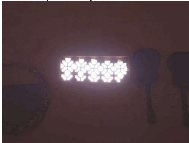
Figura 3. Abertura para ventilação natural localizada no ambiente.
