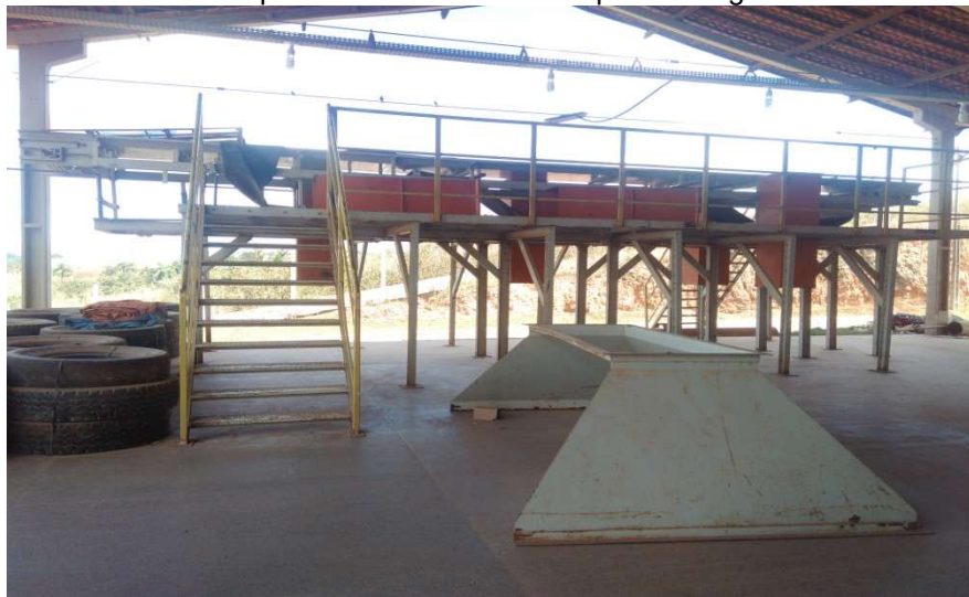
Figura 2. Infraestrutura de apoio do aterro controlado para a triagem e coleta seletiva do lixo
