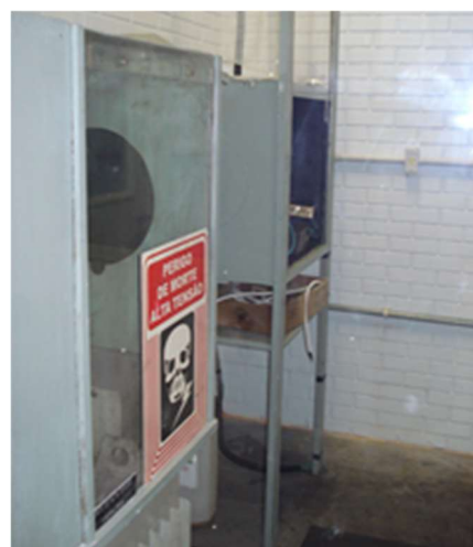
Figura 8. Equipamento de Alta Tensão
